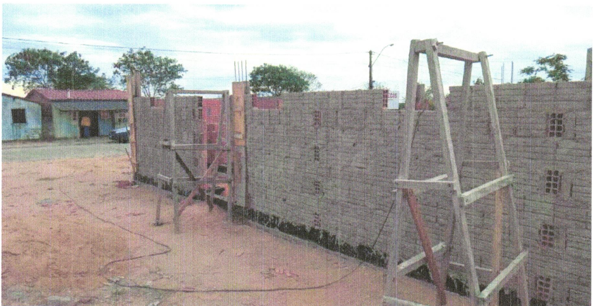
FOTO 8 - CHAPISCO APLICADO EM ALVENARIAS E ESTRUTURAS DE CONCRETO INTERNAS, COM COLHER DE PEDREIRO. ARGAMASSA TRAÇO 1:3 COM PREPARO EM BETONEIRA 400L. AF_06/2014
